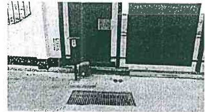
Ubicación de la salida de agua residual hacia drenaje municipal
