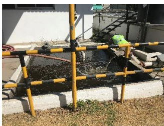
Acceso para la Toma de Muestra de Salida del Agua ya Tratada
