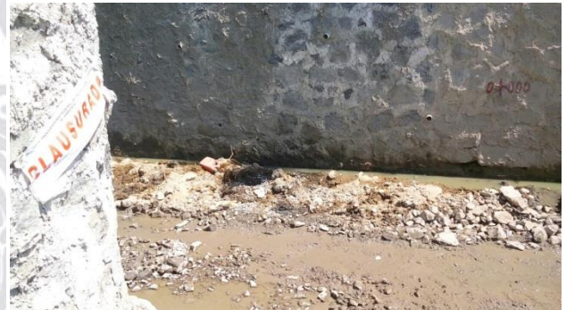
Sello de Clausura sobre muro de contención y cadenamiento a la derecha
