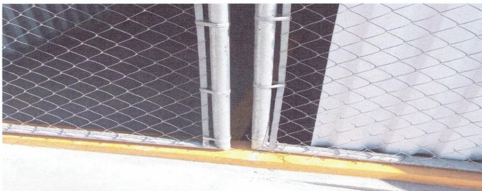
Figura 1. Nivel a la entrada de almacén temporal de residuos peligrosos, el cual impide el flujo del agua pluvial dentro de dicha infraestructura, identificándose de color amarillo.
