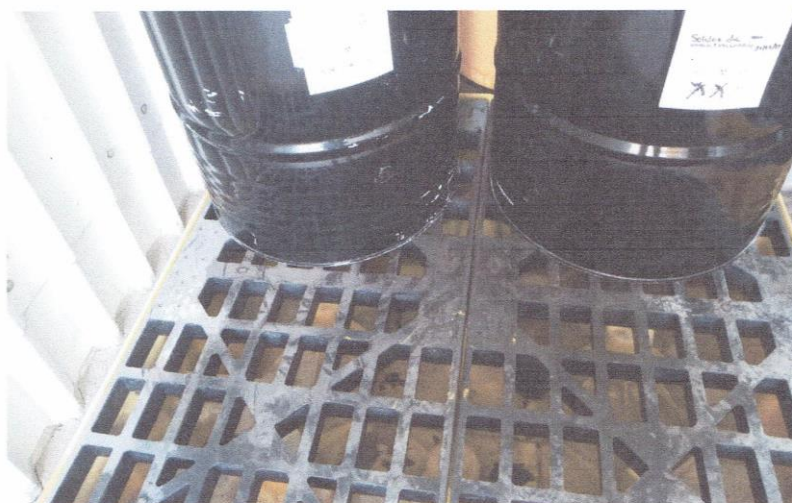
Figura 3. Mecanismo para la contención de residuos peligrosos en caso de presentarse algún derrame (charola antiderrame), situación favorecedora, dado que los residuos no se encuentran en contacto directo con el piso de concreto de esa infraestructura y con los posibles agentes externos que pongan en riesgo las condiciones óptimas para su almacenamiento.
