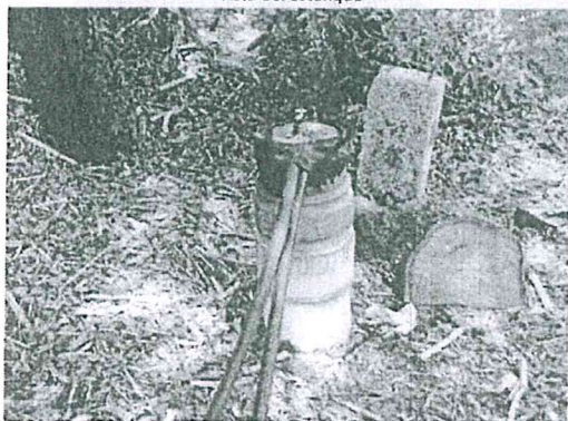
Vista de una de las toma de agua
